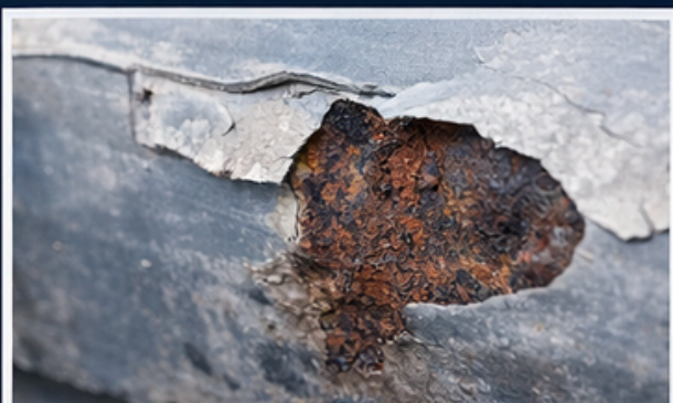
✓ Corrosión bajo película
